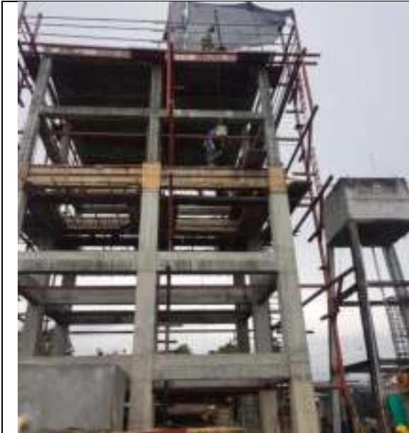
PROCESO DE VACIADO DEL CONCRETO PARA EL REFORZAMIENTO DE LA ESTRUCTURA DEL TANQUE ELEVADO.
